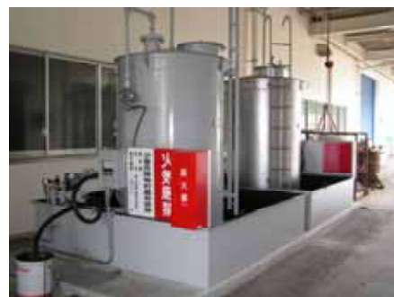
新しく設置した廃油タンク
